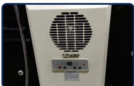
PAINEL COM AR CONDICIONADO
